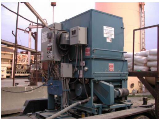
Rysunek 3 – Widok ogólny dozatora Sasobitu. W dolnej części widoczny ciśnieniowy przewód transportujący granulki
