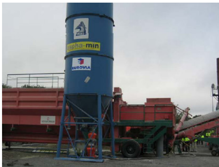
Rysunek 13 – Stały silos przeznaczony do magazynowania zeolitu. U podstawy silosa widoczny jest mechanizm transportujący drogą pneumatyczną zeolit do otaczarki.
